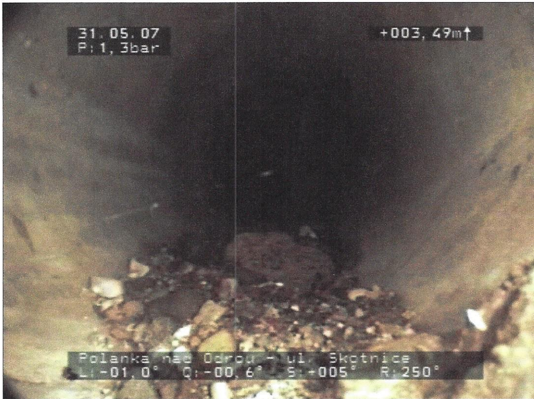
Sedimentace štěrku v potrubí v ulici Skotnice
