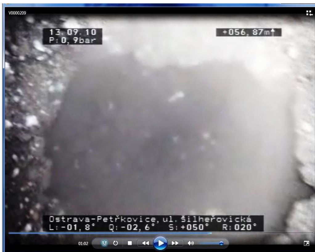
Scházející část stěny potrubí
