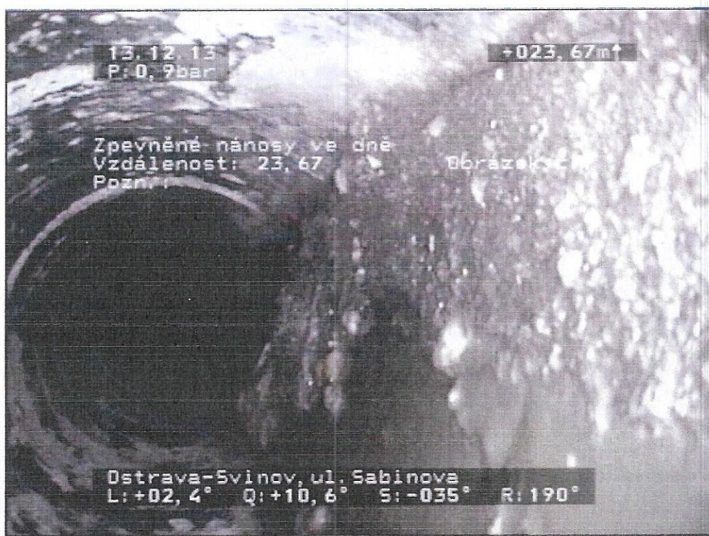
Zpevněné nánosy v potrubí v ulici Sabinova
